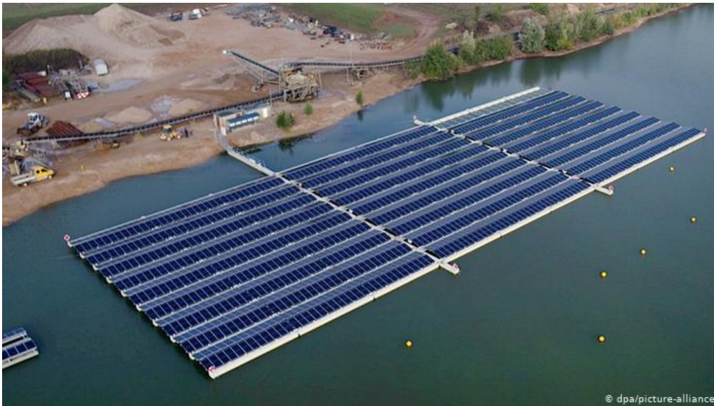
Плавающая солнечная электростанция в карьерном озере в немецком городе Веце
